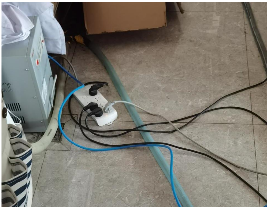
理工楼 1401 房间：插线板放在地上、电线搭在横梁
