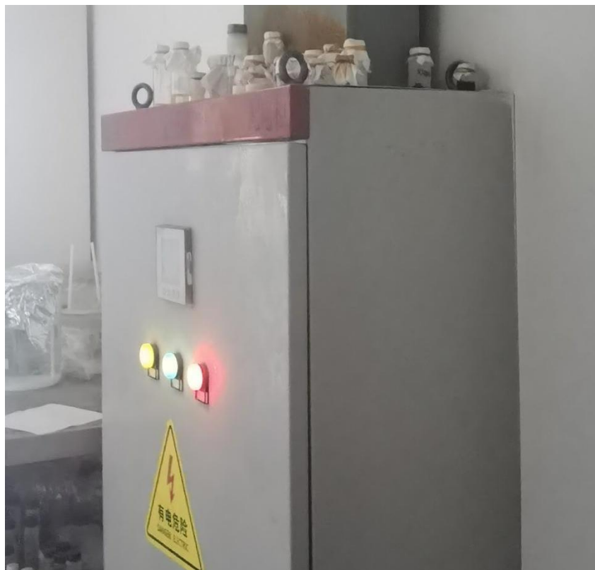
理工楼 1411: 配电柜上药品腐蚀柜体和管道
